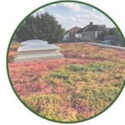
Sedum dak meer insecten, klimaatbeheersing in het gebouw
